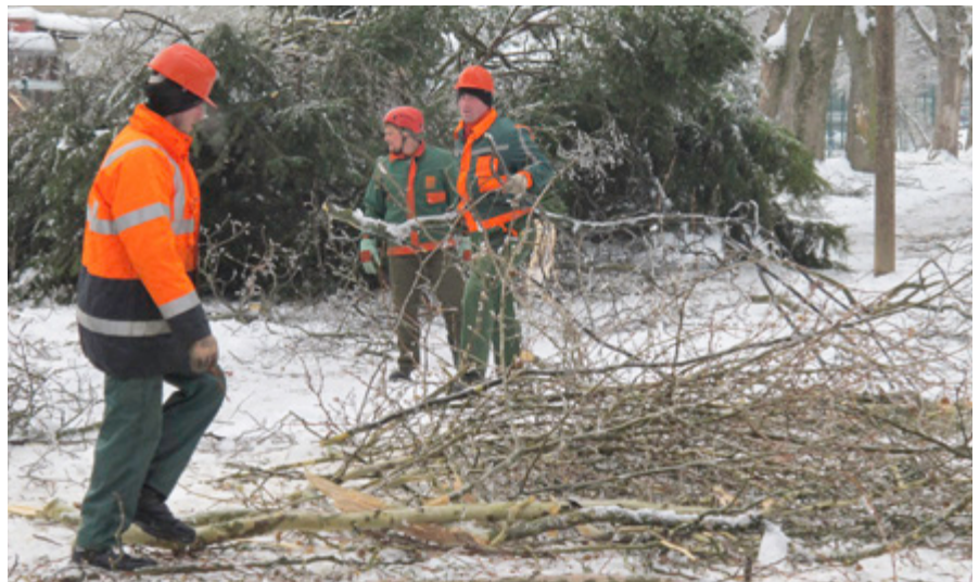
Inšpektorji za delo poudarjajo, da potrebujejo delavci za delo v gozdu ustrezno varovalno opremo.
